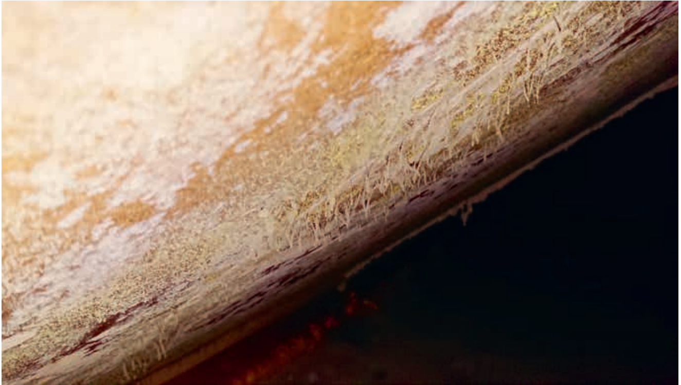
Afbeelding 5: schimmel op dakplaten achter knieschot.
