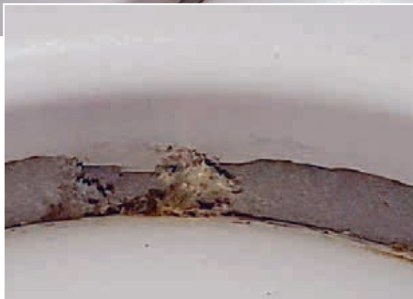
Afbeelding 2 en 3: Volledig verstopt ventiel door vervuiling. Onder een close-up.
