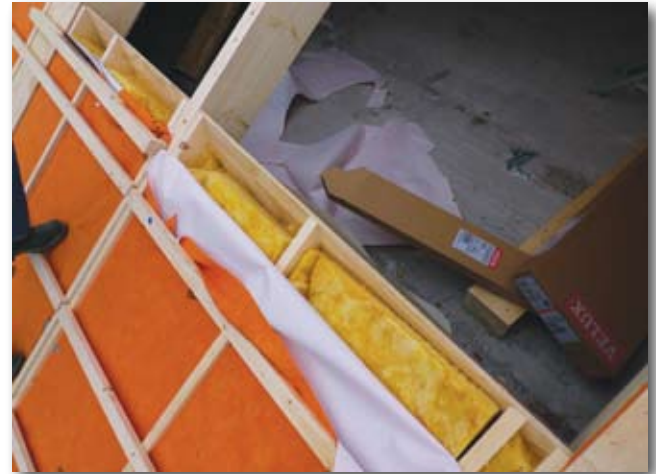
Afbeelding 3: slechte aansluiting isolatie.
