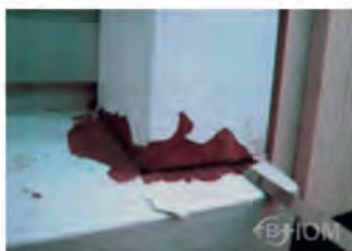
Loslatend verfwerk rondom open houten kozijnverbinding.
