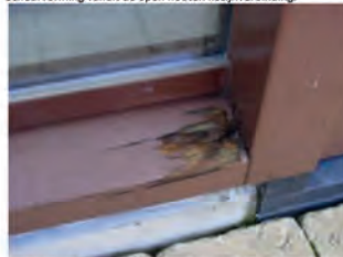
Houtaantasting door open houten kozijnverbinding.
