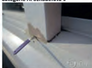
Loslatend verfwerk rondom open houten kozijnverbinding.
