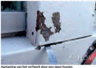
Aantasting van het verfwerk door een open houten kozijnverbinding.
