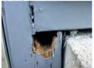
Houtaantasting door open houten kozijnverbinding.
