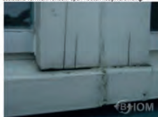
Scheurvorming vanuit de open houten kozijnverbinding.
